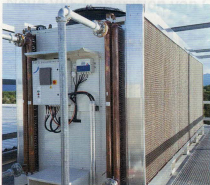
Das Rückkühlwerk der Absorptionskälteanlage „ECO-Cooler“
