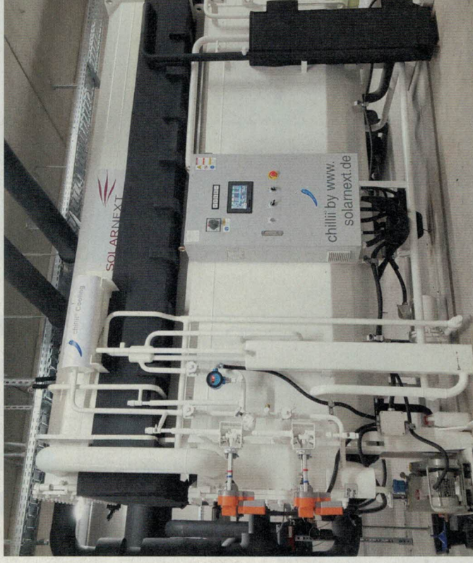
Im Bahnhofsgelände Nord Rosenheim arbeitet die Absorptionskälteanlage „chillii Cooling Kit“ der Solarnext AG. Sie stellt mithilfe von bis zu 95 Grad Celsius heißem Wasser Kaltwasser mit 8 Grad Celsius für die Klimatisierung des Quartiers bereit. Bilder: Solarnext
