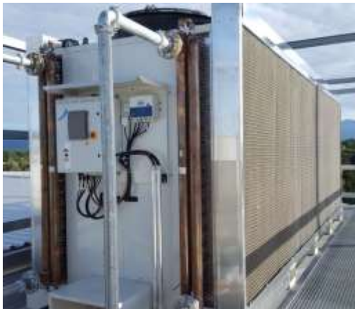
Die Abbildung zeigt das Rückkühlwerk der Absorptionskälteanlage „ECO-Cooler“ (Beide Abb. © SolarNext AG)
