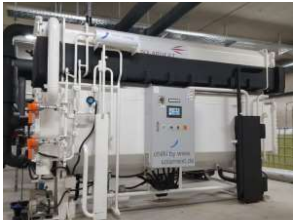
Die im Quartier Bahnhof Nord in Rosenheim installierte Absorptionskälteanlage „chillii® Cooling Kit“ der SolarNext hat eine Kälteleistung von 220 kW
