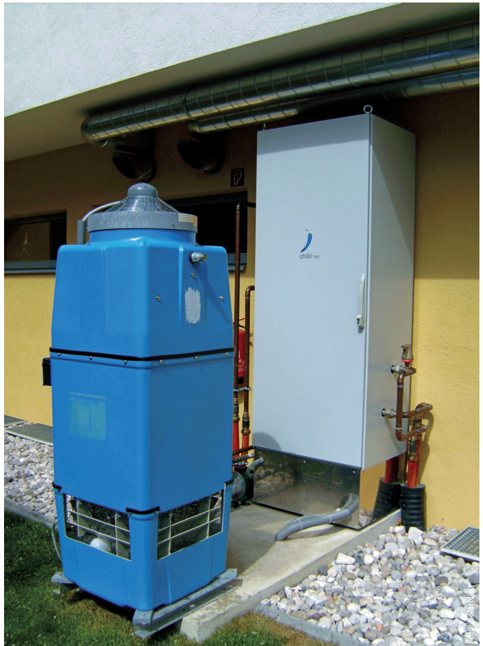
Solar betriebene 10 kW Ammoniak/Wasser Absorptionskältemaschine chillii® PSC10 mit Nasskühlturm des Trainingcenter und Bürogebäudes der Bachler Austria GmbH in Gröbming, Österreich
