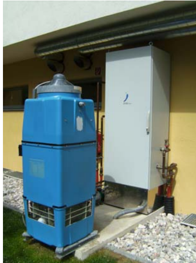
Abb. 7: Ammoniak/Wasser Absorptionskältemaschine chillii® PSC10 mit Nasskühlturm (Quelle: SolarNext)
