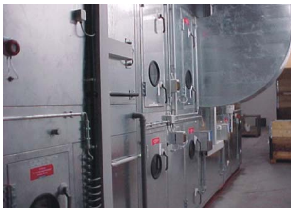
Abb. 4. Solarunterstützte DEC Anlage in einem Fabrikgebäude in Althengstett (Quelle: zafh.net)
