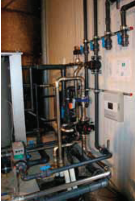
Die installierte Anlage
