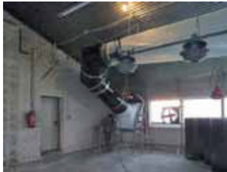
Ein Blick auf die Kühlverteilung des Putenstalls
