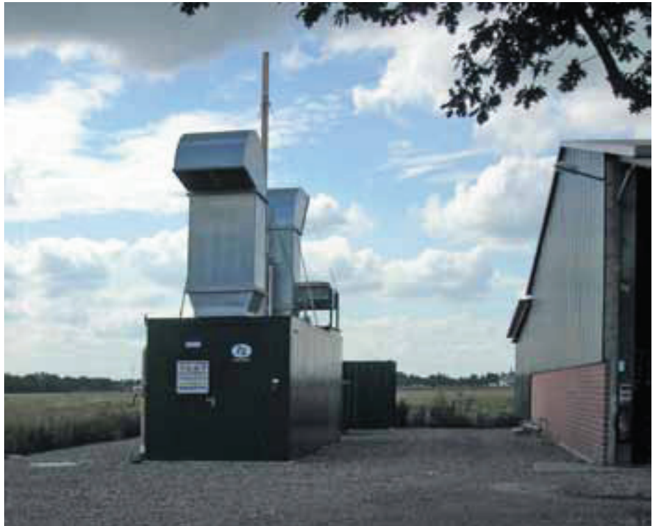
Das biogasbetriebene BHKW mit einer Gesamtleistung von 350 kW nutzt die Abwärme von etwa 95 °C als Antriebsenergie mit etwa 70 kW zum Betrieb der thermischen Kühlanlage
