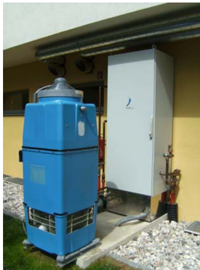
Abb. 1: Solar betriebene 10 kW Ammoniak/Wasser Absorptionskältemaschine chillii ® PSC10 mit Nasskühlturm des Trainingcenter und Bürogebäudes der Bachler Austria GmbH in Gröbming, Österreich (Quelle: SolarNext)
