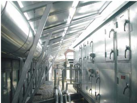
Figura 5: Sistema DEC sul tetto della biblioteca a Mataró (Fonte: zafh.net)
