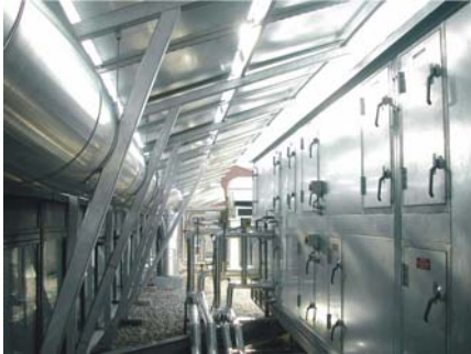
DEC-Anlage auf dem Dach der Bibliothek in Mataró (Quelle: zafh.net)
