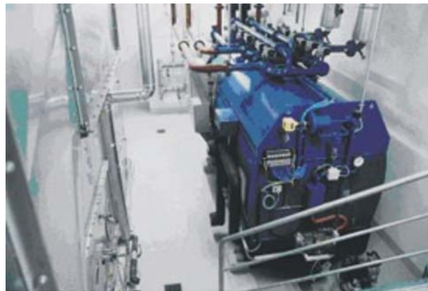
Abb. 3. Adsorptionskältemaschine an der Uniklinik Freiburg (Quelle: Fraunhofer ISE)
