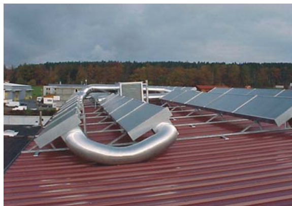
Abb. 12: 100 m 2 solare Luftkollektoranlage zur Regeneration der Sorptionsanlage in der Produktionshalle Althengstett (Quelle: zafh.net)
