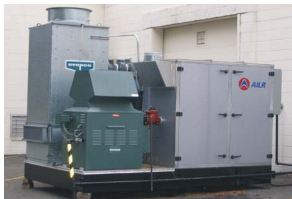
Abb. 10: Feldtest Flüssigsorptionssystem OA-6000 mit Kühlturm und Heizkessel [25]
