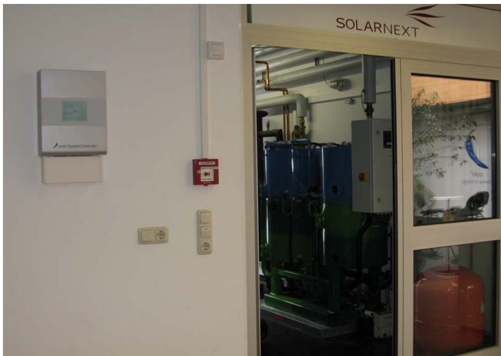
Abbildung 4: chillii® System Controller HC und Absorptionskältemaschine chillii® ESC15 des solaren Kühlsystems der Hightex GmbH (Quelle: SolarNext)
